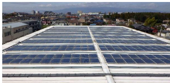
従来よりサガミ工場に設置されている 太陽光パネル
